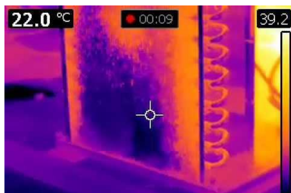
Figura 10.7.5: Imagen Termográfica de Condensador Obstruido
