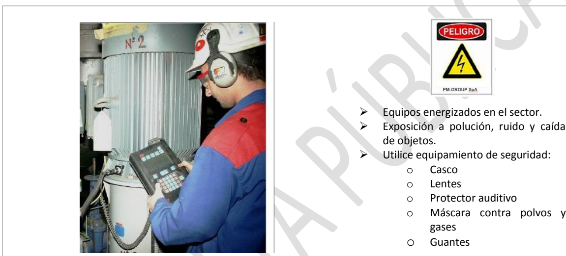
2274 Figura 10.1.10: Medición de Vibraciones del motor
