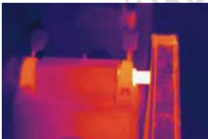
Figura 9.4: Medición de temperatura de un conjunto de rodamientos
